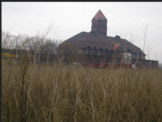
Niszczący budynek cechowni przed remontem
